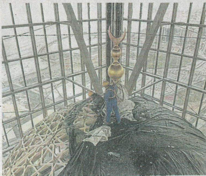
Installée à Ozoir-la-Ferrière, la société Franklin France équipe en paratonnerres la grande mosquée d'Alger, qui devrait être achevée en fin d'année.
